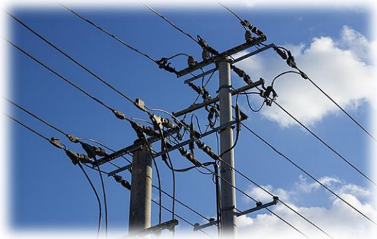
เสาไฟฟ้า
